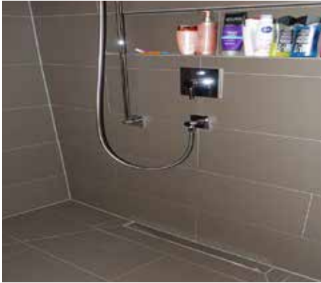
Die Dusche hat eine «Joulia Duschrinne», welche einen Teil der Abwasserwärme rückgewinnt.
