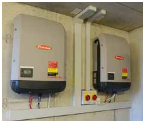
Die Wechselrichter machen aus dem Gleichstrom vom Dach Wechselstrom fürs Stromnetz. Da sie summen, sind sie hier in den Technikraum verbannt.
