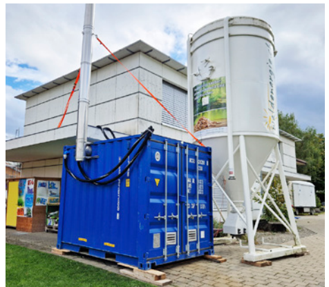
Das Schulhaus und der Kindergarten in Gerzensee werden diesen Winter von dieser provisorischen Pellet-Heizanlage warmgehalten.
